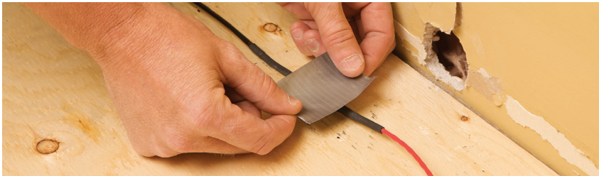
FIGURE 2.23 : Fixer le conducteur froid au faux plancher
